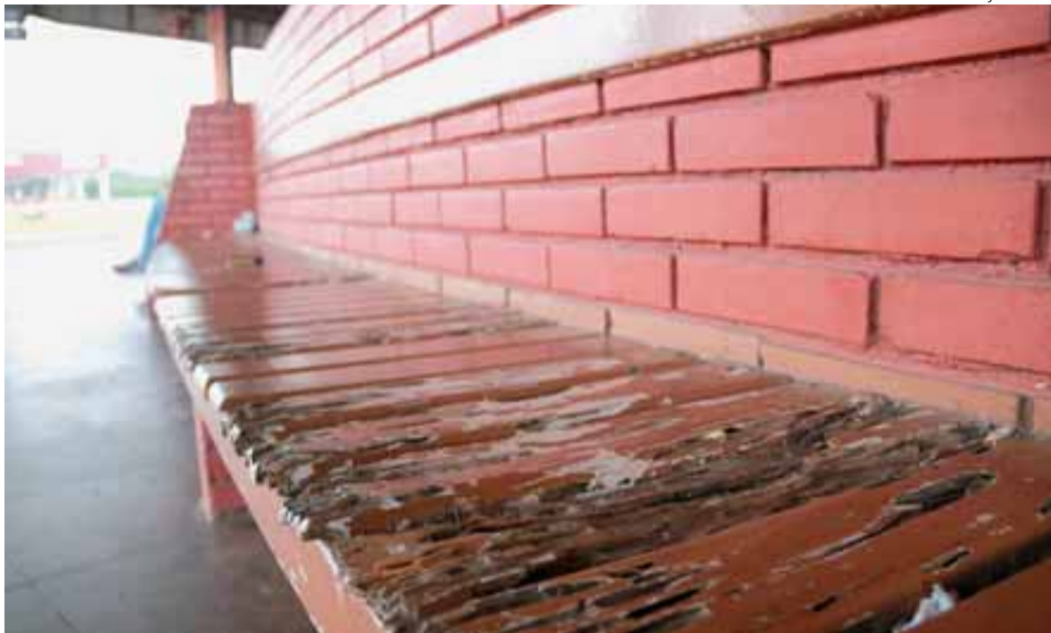
Terminal inaugurado há mais de 40 anos jamais passou por uma reforma profunda, o que levou ao estado de grande deterioração
